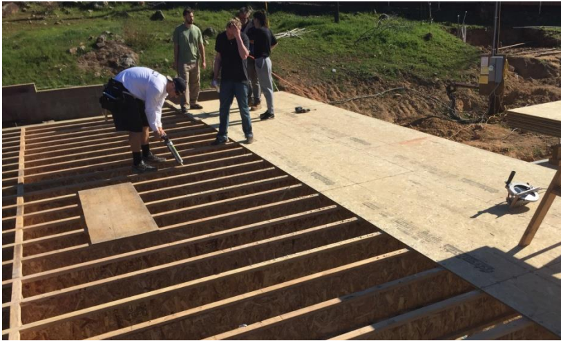
Derek, un de mes pasteurs, en train de coller et clouter des planches pour le plancher de la future maison
